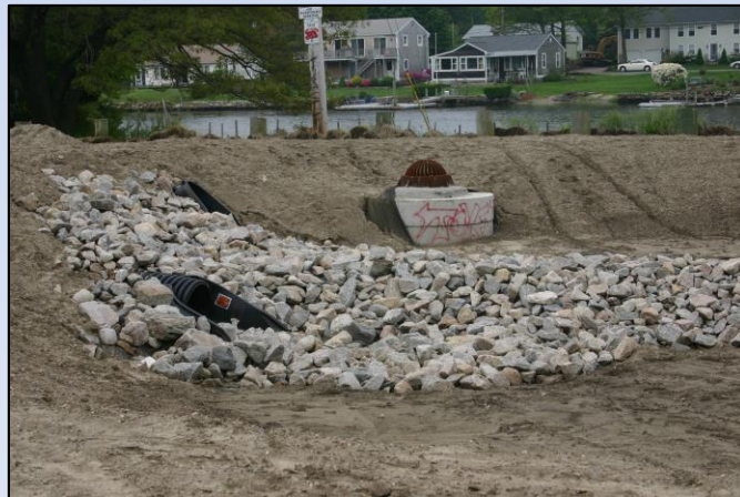
Mettatuxet Detention Pond - 2006
